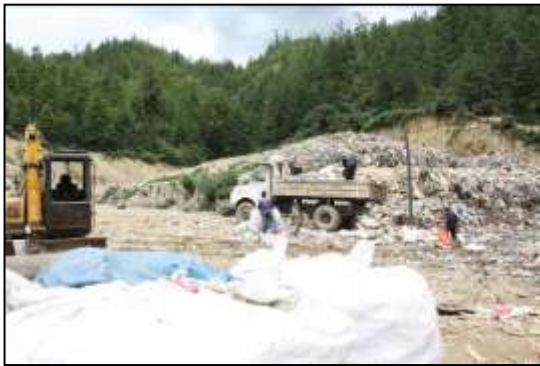
写真 8 メメラカゴミ処分場(ティンブー郊外)
